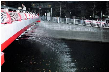
御成橋に設置された放水施設
