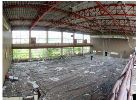
図 天井の崩落
