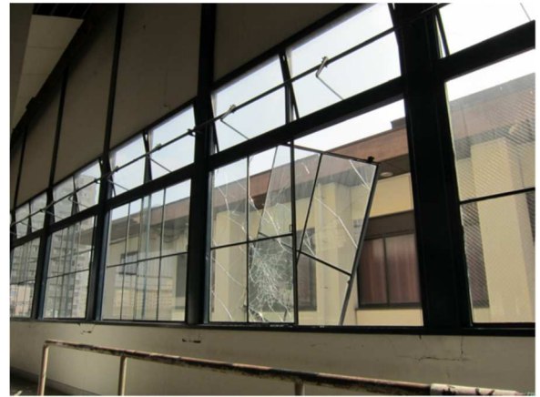
図 窓ガラスの損傷
