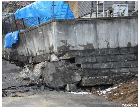
図 地震による擁壁の崩壊のイメージ 写真提供：宮城県仙台市
