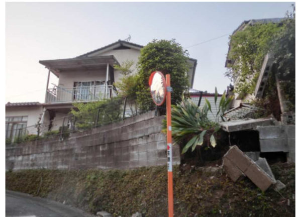
図 ブロック塀倒壊
