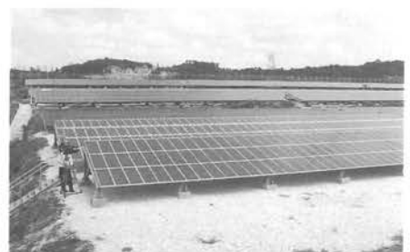
七又の太陽光発電施設 750kw発電
