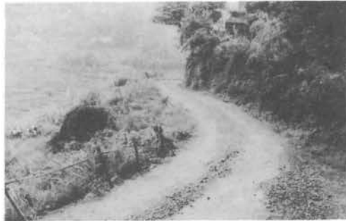
道路改良工事が望まれている県道大谷線
