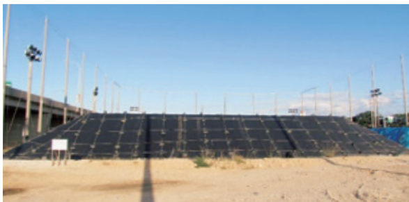
要請後沖縄防衛局により、台風対策として、遮水シートにより養生された廃棄物混じり土
