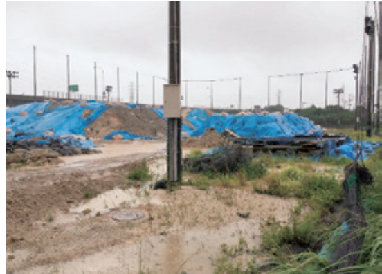
台風後、ブルーシートの捲れや破損が確認できる。
