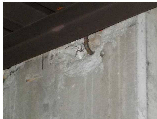
爆裂のようす（舞台内部）
