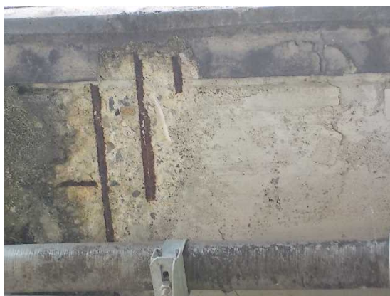
爆裂のようす（会議棟軒天）
