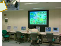
局2F 集中監視センター
