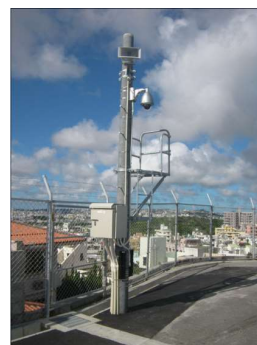
豊見城配水池内の監視カメラ
