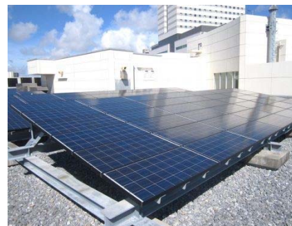
太陽光発電設備
