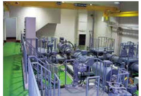
ポンプ場の中
