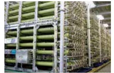
海水淡水化施設内部
