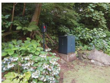
【防災設備】昭和57年
