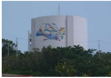
喜友名配水池
