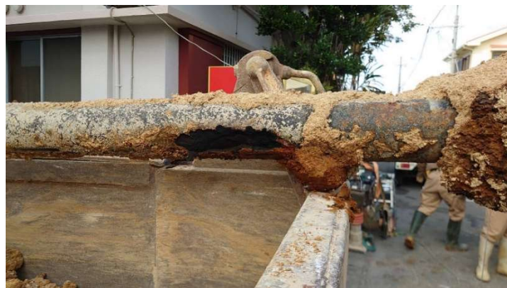
老朽化した配水管
