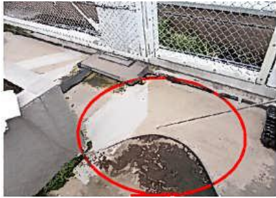
床防水の浮き
