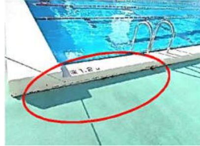
屋上プール 外縁のシールの劣化
