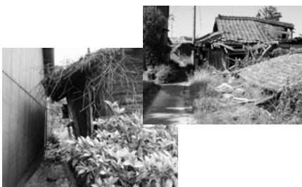
▲崩壊寸前の空き家
