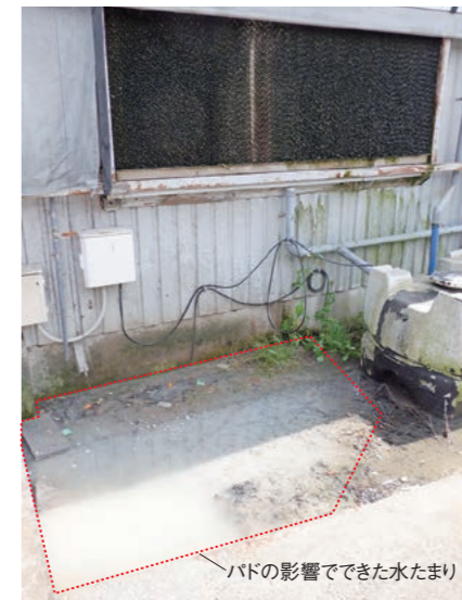
写真1 パドの下にできた水たまり
