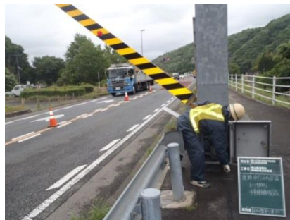
通行止め設備の操作状況
