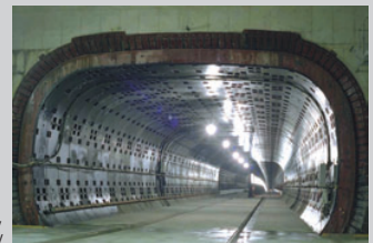
京都市地下鉄 大断面矩形シールドの設計 A large sectional rectangular-shaped shield, Kyoto Subway
