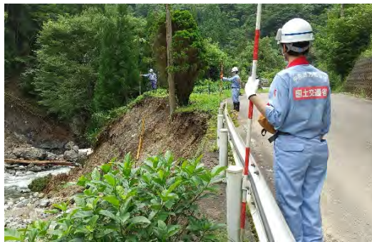
令和2年7月豪雨（九州地方）での被災状況調査（河川）
