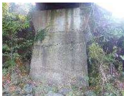
▲橋梁 ひび割れ補修施工前
