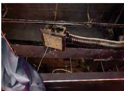
手入れをされていない換気扇
