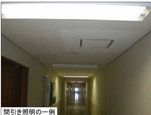
間引き照明の一例
