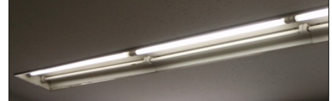
蛍光灯ダミー管設置 (左: 蛍光管、右: ダミー管)
