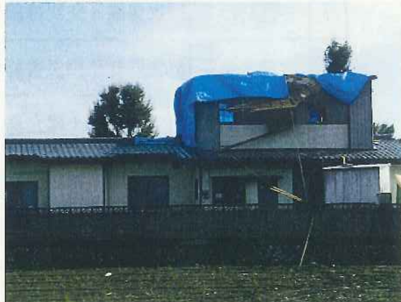
屋根の損壊②
