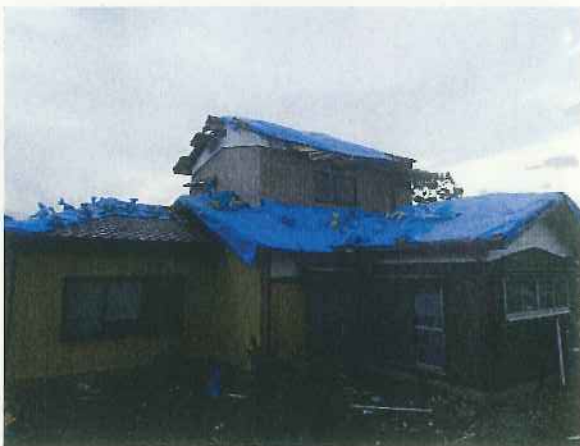
屋根の損壊 【栃木市都賀町家中地区】
