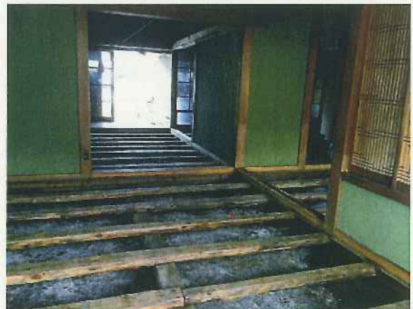
浸水被害を受けた住宅 【徳島県那賀町鷺敷地区】
