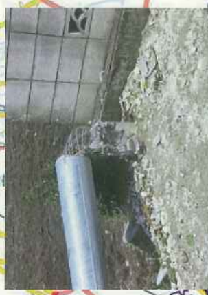
コンクリート製電柱の折損
