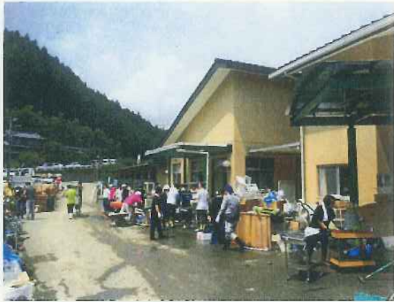
浸水被害を受けた社会福祉施設の復旧作業の様子 【徳島県那賀町相生地区】
