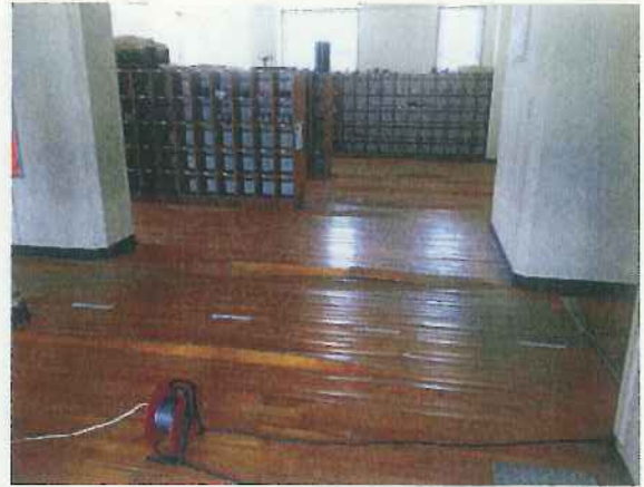
被害を受けた小学校校舎の様子 【徳島県海陽町穴喰地区】
