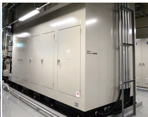
ガスエンジン・コージェネ(400kW×1台)
