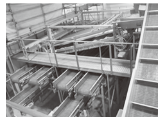
搬送プラント設備
