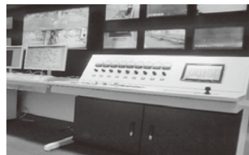
中央監視装置
