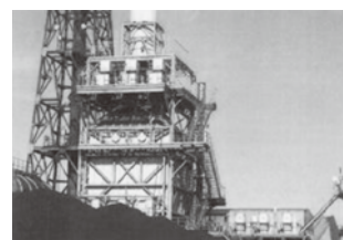
電気集塵機設備
