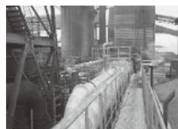
ガス燃料供給ライン設備
