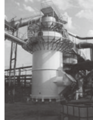
八戸製錬所 硫酸設備 吸収塔
