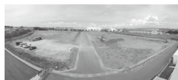
1.7M太陽光建設(R5年1月)完成
