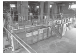
下水処理施設バイオダイエット装置
