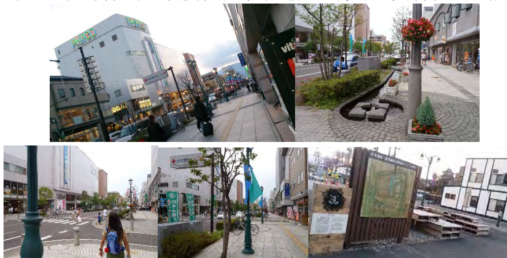
図表 3-4 中心市街地中心部(伊勢町)と松本城前の道路拡張工事(写真右下)の様子
