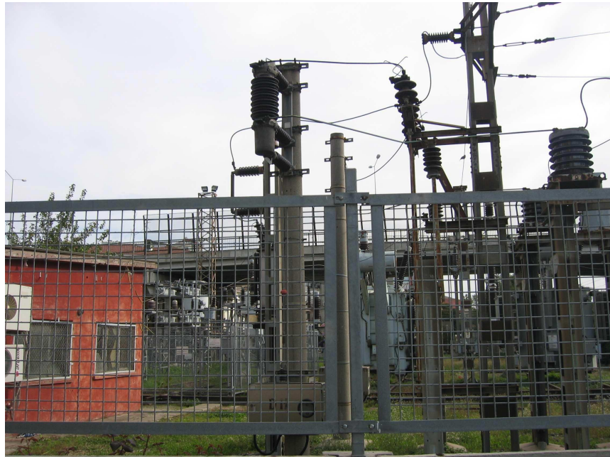
Figura 3. Situación actual. Subestación de Idealtepe
