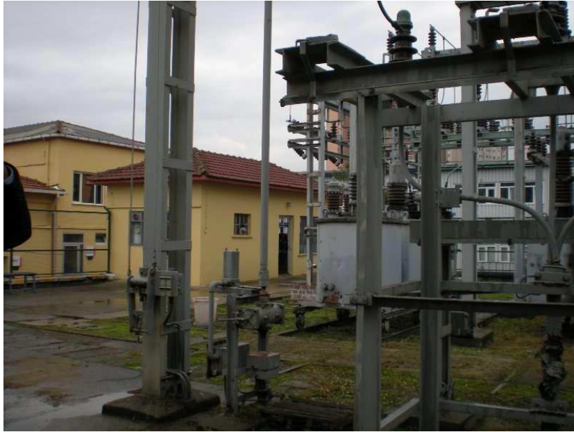
Figura 2. Situación actual. Subestación de Veliefendi
