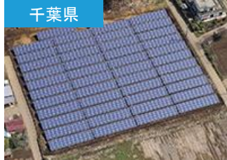
S-03 LS千葉若葉区発電所
