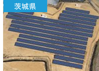
S-02 LS筑西発電所
