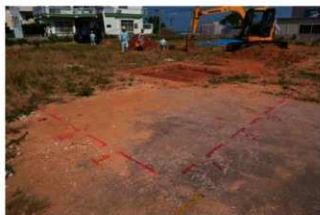
確認坑 設定状況
