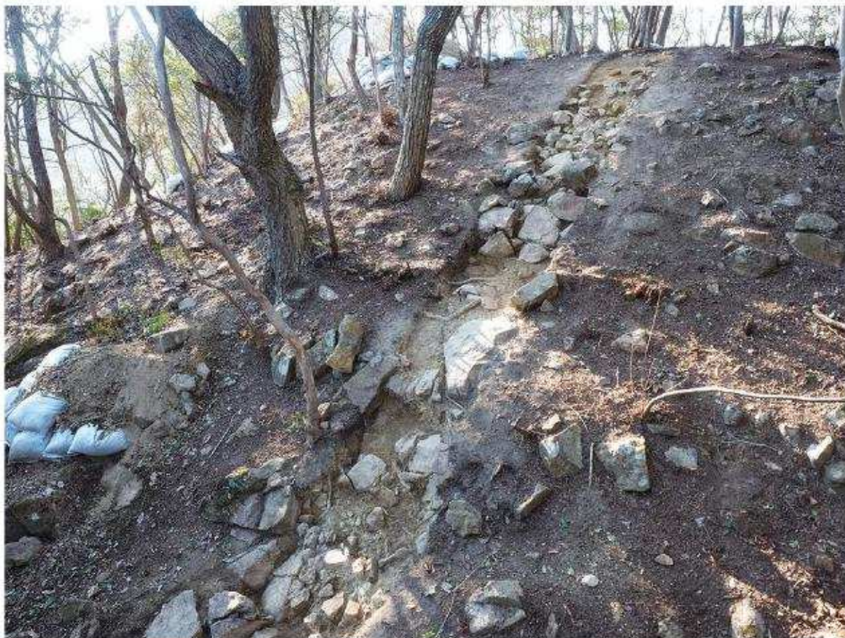
後円部2調査区・全景 南東から。写真手前が後円部1段目斜面基底石。堆積土はほぼ無く、表土直下で大量の石材及び岩盤が検出されている。2段目斜面は比較的良好な残存状況であった。
