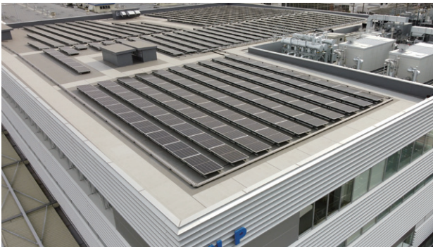
藤沢事業場 NP棟太陽光発電
