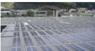
公共等施設太陽光発電事業 (33施設、535kW)
