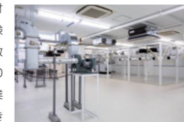
空調・電気の体験型研修室
