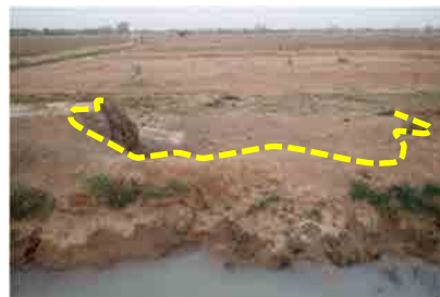
ンジャワラ灌漑地区における陥没した管理用道路
