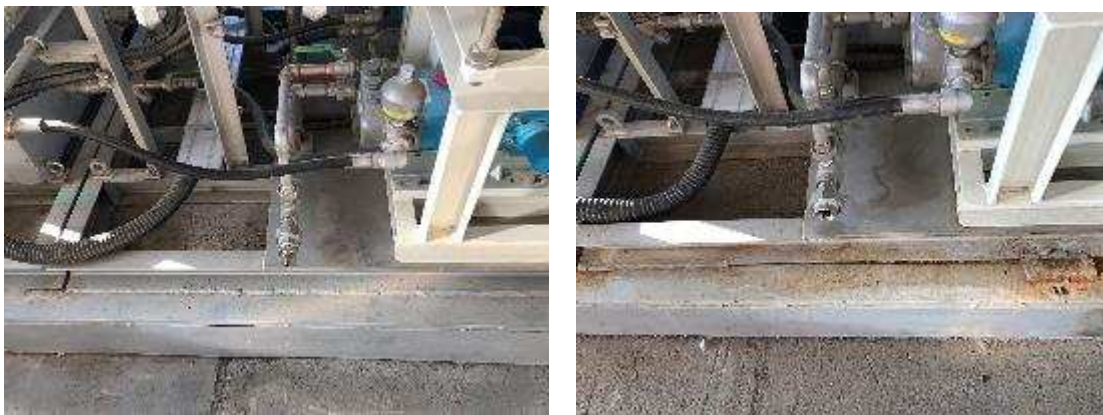
圧縮空気接続カプラ設置状況（左：1号機、右：2号機）
