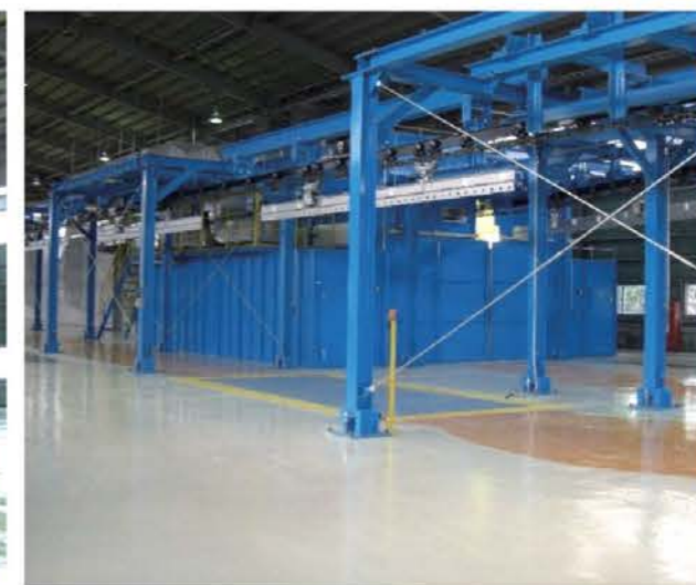
塗装ライン外観
