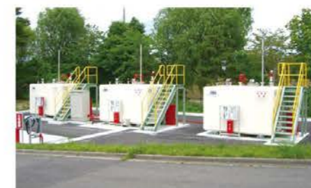
コンボルト型タンクの外観
