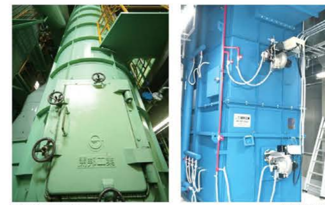
ごみ焼却炉 設備
