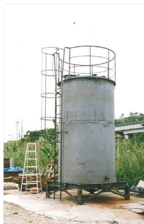
汚泥処理タンク20kℓ
