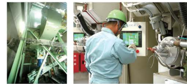
ごみ焼却炉 設備
