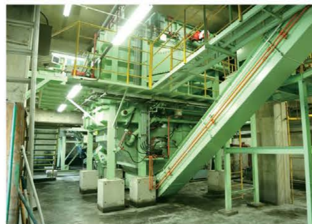
ごみ焼却炉 設備
