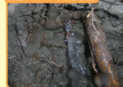
鋼管さびによる漏水状況
