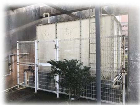
貯水槽水道の受水槽
