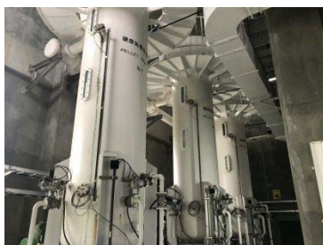
加治道浄水場 (硬度低減化施設)
