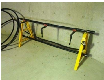
応急給水栓 (池間配水池)
