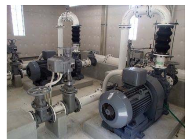
久松ポンプ場 建設年度 平成24（2012）年度
