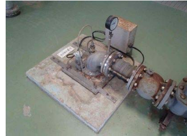
加治道 - 1号ポンプ 建設年度 昭和40（1965）年度
