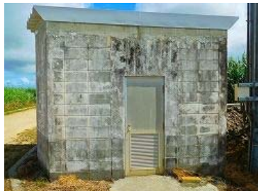
下北増圧ポンプ場 建設年度 平成元（1989）年度
