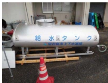
給水タンク 1.5m 3 ×2基
