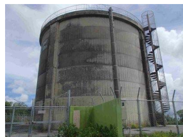
二重越配水池
