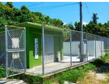
前浜ポンプ場 建設年度 昭和49（1974）年度
