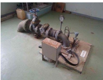
加治道 - 2号ポンプ 建設年度 昭和40（1965）年度
