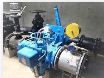
緊急遮断弁 (牧山配水池)
