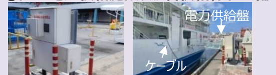
陸上電力供給施設(泊ふ頭地区)
