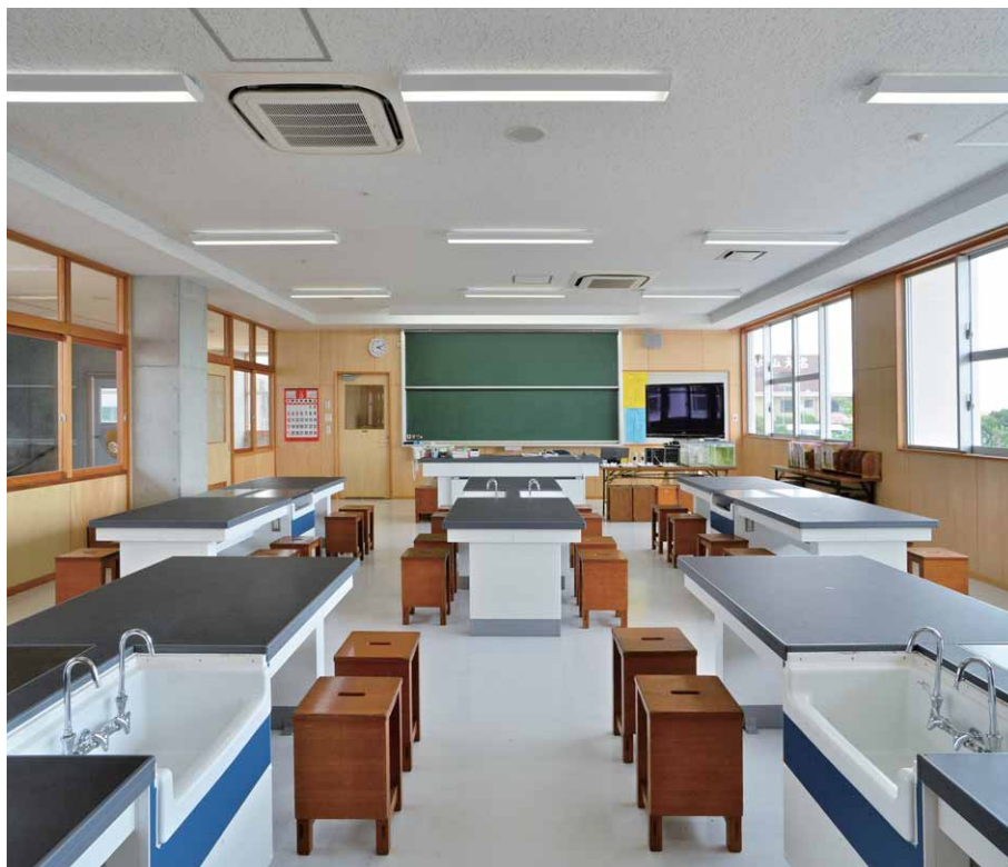
理科教室の照明 LEDベースライトAQシリーズ直付形スクールソフト(非調光タイプ)を均等配置
