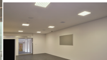
メルティングポットの照明 LEDベースライトスクエア器具を採用
