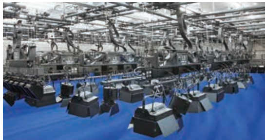
階段上部よりスタジオ照明設備を望む
