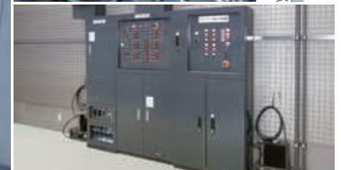
昇降操作装置（左から照明特電盤、昇降装置盤、吊りマイク装置）
