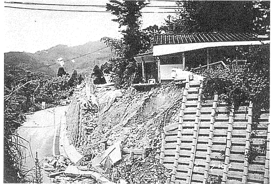
写真-13 井桁擁壁の再破損状況 (宮之城町久木野A; No.1)
