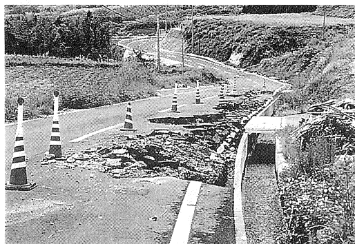
写真-6 道路の被災状況 (宮之城町市野; No.5)
