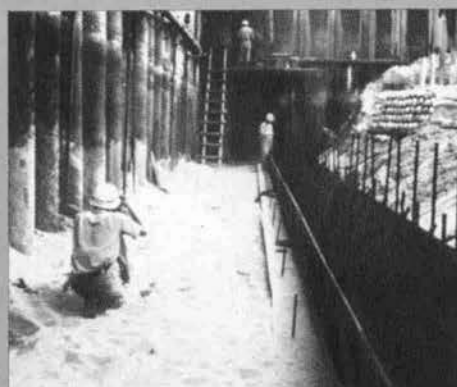
▲ (上) 鋼管矢板による締切り (中) 作業室砂セントルの築造 (下) 刃口金物（ケーソン沓）の据付
