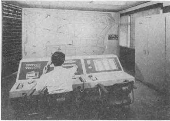
写真-1 管制指令室 (千葉国内)
