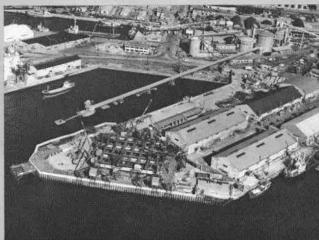
◀既設構造物と近接した築港側ケーソンの施工 (倉庫とケーソン外壁との離れ約10m)
