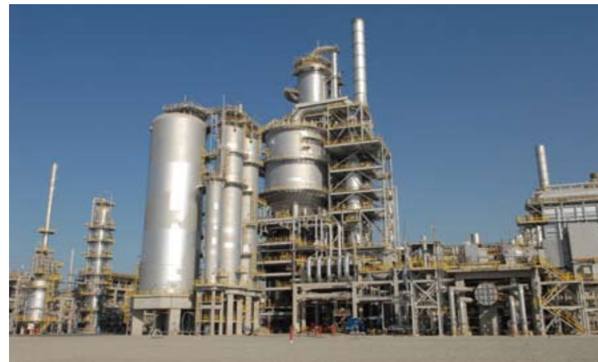
Oman Oil Refineries and Petroleum Industries Company (ORPIC) 向け石油精製プラント (オマーン)
