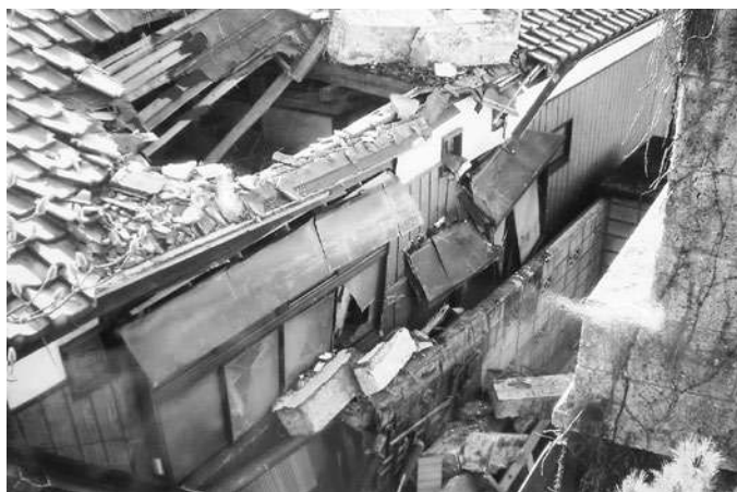
東日本大震災の被害認定調査の記録。隣地の石倉の石材が屋根に落下した家屋
