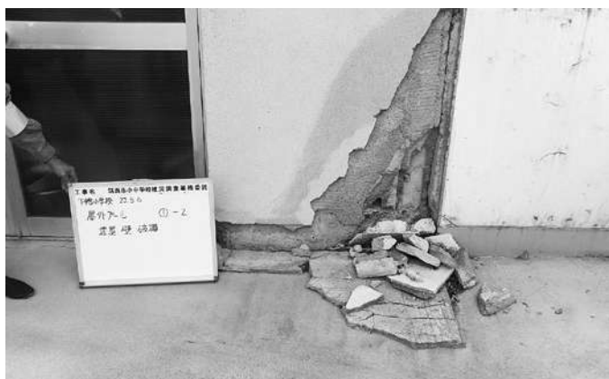
筑西市立小・中学校震災災害調査の記録。屋外プール施設の壁が剥落
