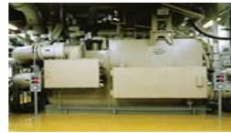
海水熱源ヒートポンプ
