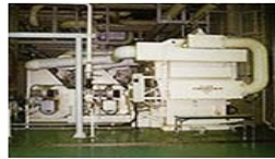
ガス吸取式冷水機
