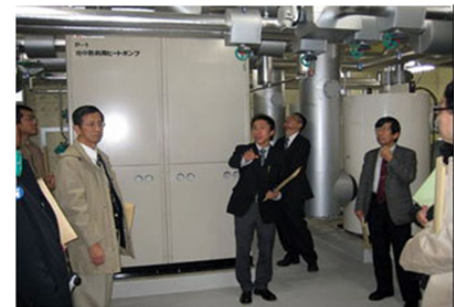
秋田市立山王中学校 機械室内の地中熱利用ヒートポンプ設備
