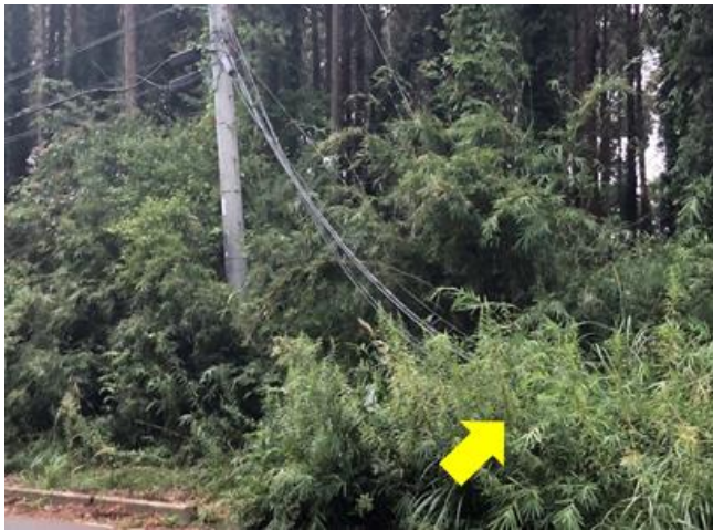
図1 倒木により切られた電線
