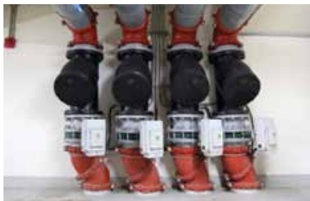
台北101雨水收集系统
