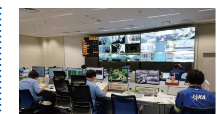
バルブ操作やセンサの監視を行う管制室の様子。
