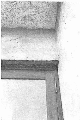
写真-17 北斗小学校体育館 梁端亀裂
