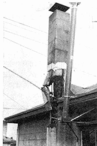
写真-3 桂木団地煙突の損傷
