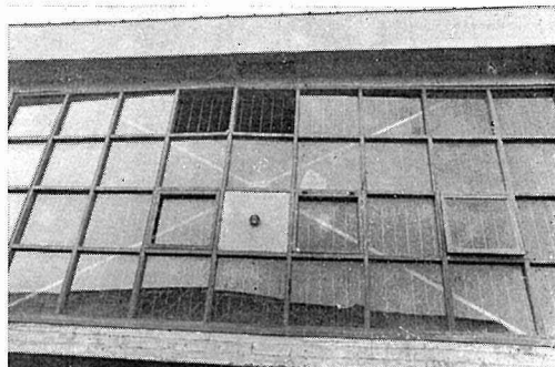
写真-14 光洋中学校 体育館窓サッシの膨出とガラス破損
