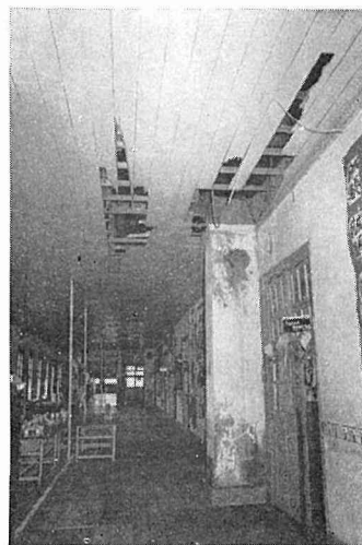
写真-19 花咲港小学校煙突の崩落
