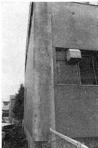
写真-7 市立根室病院外来棟柱の剪断亀裂
