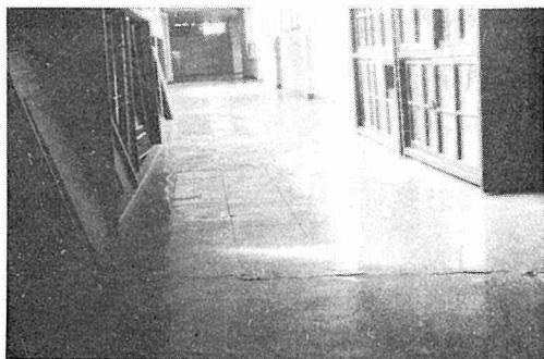
写真-15 北斗小学校, 廊下の亀裂
