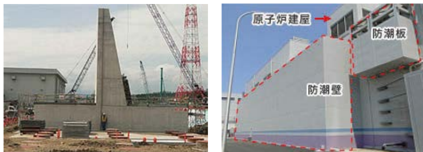
図 1-11 東京電力柏崎刈羽原子力発電所の防潮堤、防潮壁・防潮板
