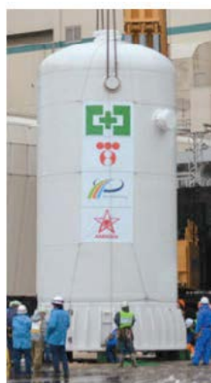
フィルタベント設備
